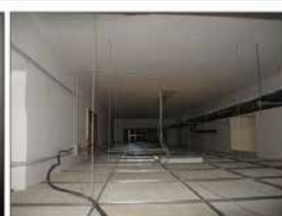
Foto n°2 - Vista di insieme del sistema di pendinaggio.
